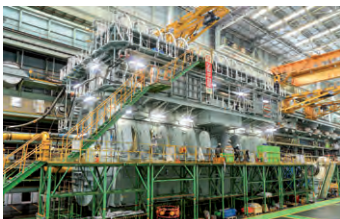
Til venstre: Diesel House ved H.C. Ørsted Værket. Til højre: Den store motor i Diesel House, der blev bygget af B&W i 1933. Fotos: Diesel House.
