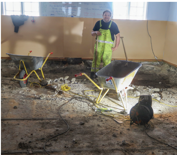
Under de nyere trægulve var der i flere rum støbt med beton med indstøbte strøer
